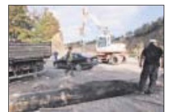
Bei Straßenarbeiten wurde ein Telefonkabel zerrissen. (HK)
